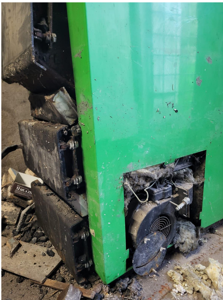
Uszkodzony piec w budynku Sali wiejskiej w Świerkach
