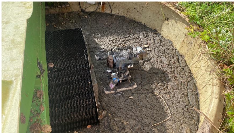
Oczyszczalnia ścieków – budynek komunalny - Ludwikowice Kł., ul. Fabryczna 27
